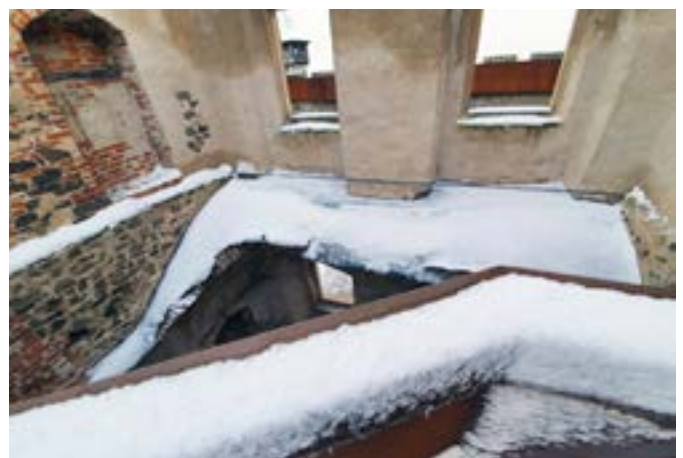
Interiéry „rekonstruovaného“ paláce hradu Helfštýna v listopadu 2021.
